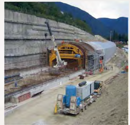
Circonvallazione di Bressanone Bressanone Ring Road
